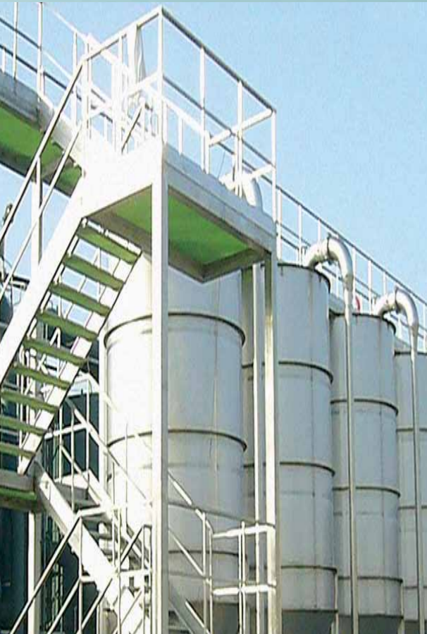
ÉPURATION DES EAUX USÉES
