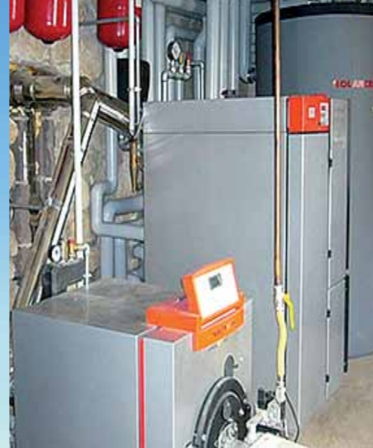
CENTRALE THERMIQUE COMBINÉE À UNE CHAUDIÈRE À BOIS
