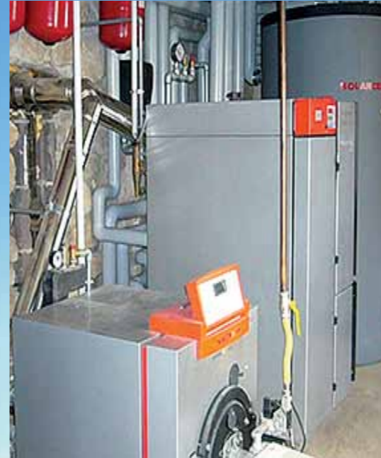
CENTRALE TERMICA GAS - BIOMASSA
