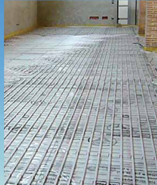
RISCALDAMENTO E RAFFRESCAMENTO
